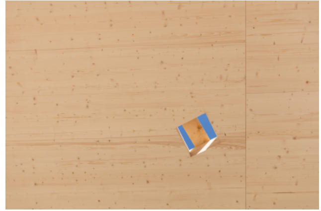
Vergessene TS3-Fuge. Foto: Tom Bause
