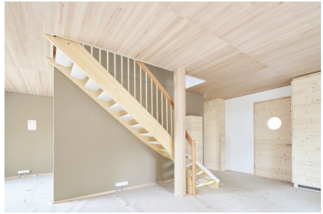
Die TS3-Technologie ermöglicht eine Stützen-Platten Bauweise. Die TS3-Fugen bleiben bei diesem Projekt sichtbar.
