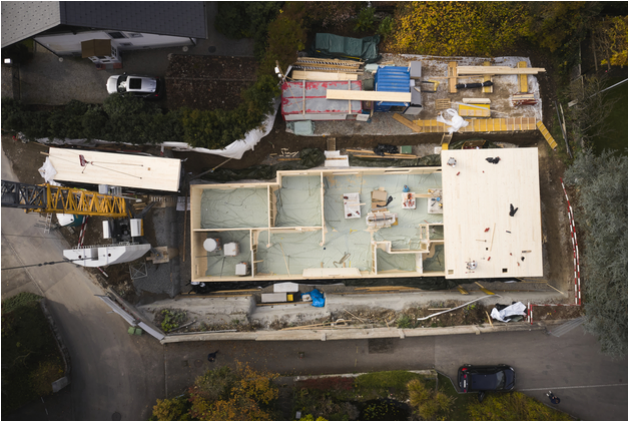
Was lange unmöglich schien, ist heute Realität: In Thun steht das erste Mehrfamilienhaus mit einem Keller komplett aus Holz.
